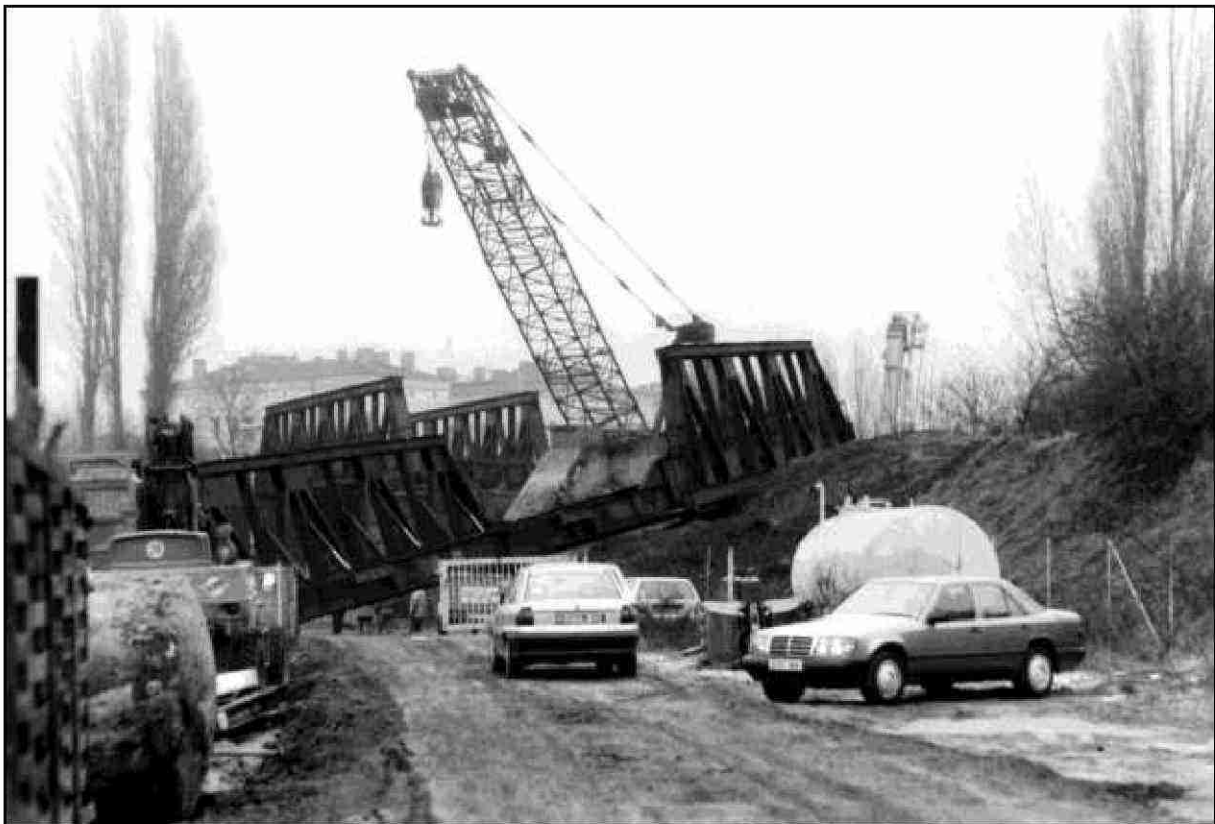
Bild 12 Demontage der obengenannten Brücken im Zuge der Baumaßnahmen „VZB“. Zur Anfahrt des im Bild sichtbaren Mobilkranes wurde die Unterführung (vergleiche Bild 4) abgerissen. Dezember 1995, 0424-12-95-14a.
