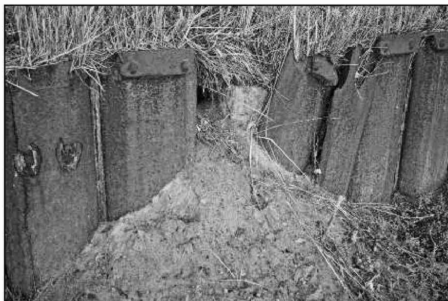
Abbildung 11: Gebrochene Schwelle, Hinterfüllung teilweise ausgewaschen
