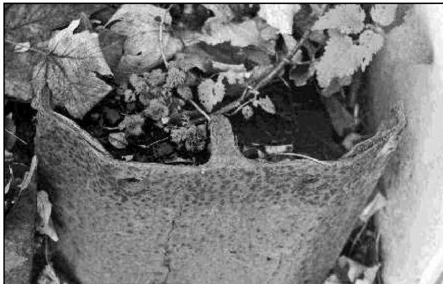
Abbildung 9: Längsschwelle Bauart Hilf, Hinterfüllung ausgewaschen
